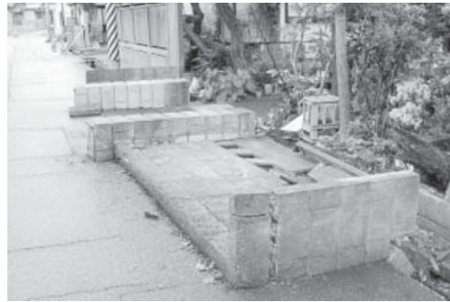
地震により、倒壊したブロック塀(平成19年新潟県中越沖地震)
